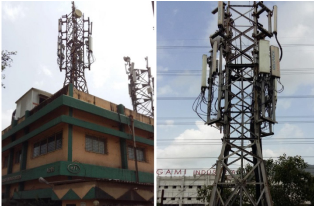
Abbildung 1: FTTH-Aufrüstung einer Basisstation
